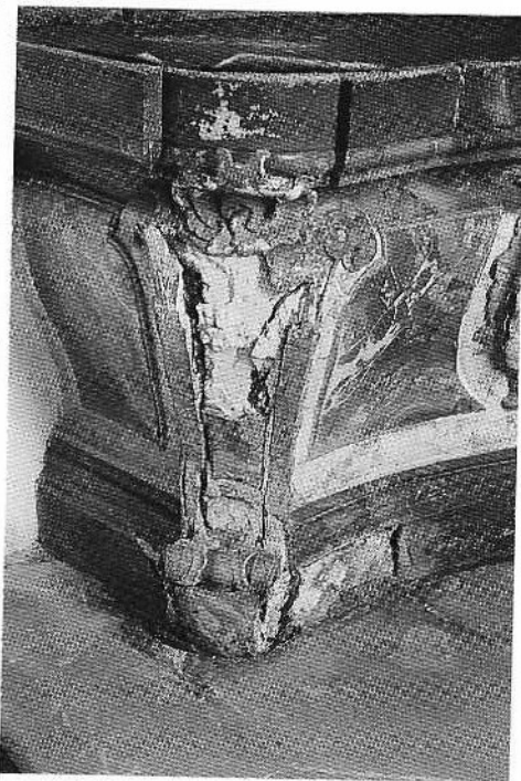
18 Kartäuserkirche Ittingen. Mensa des Hochaltars von J. Georg und Mathias Gigl 1764 f. Durch rostende Armierung verursachte Sprengschäden am Schliffmarmor.
